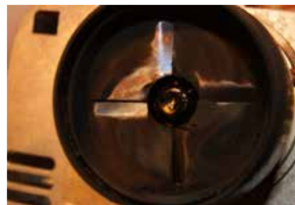
Abb. 8 Ansicht des defekten Brennstoffkopf im Brenner
