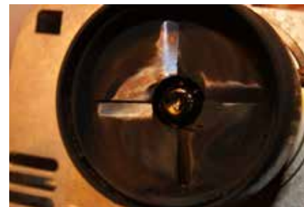
Abb. 5 Ansicht des defekten Brennstoffkopfs im Brenner
